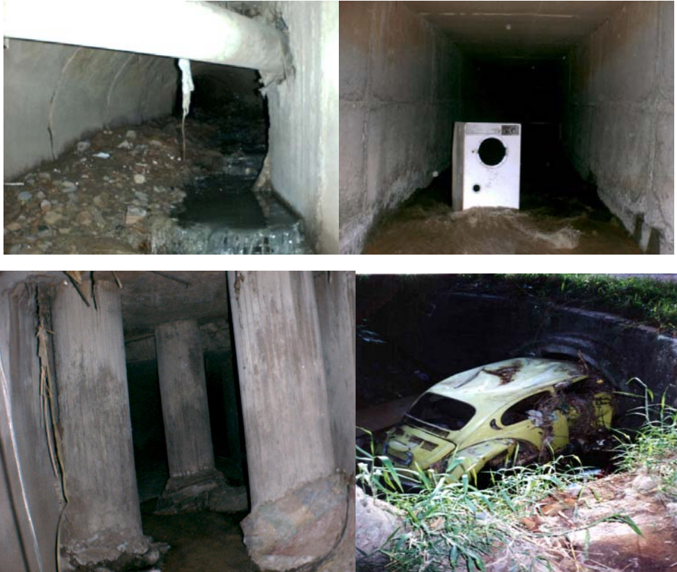
Figura 3.7 Obstrução e resíduo na drenagem (Belo Horizonte e São Paulo).
