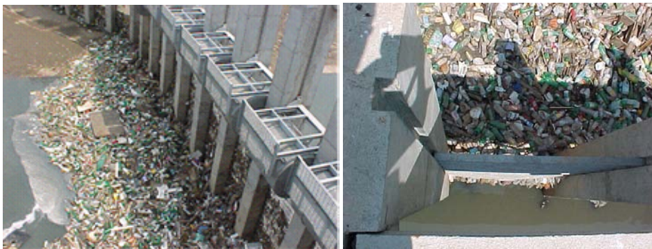
Figura 3.8 Lixo retido na drenagem (São Paulo)
